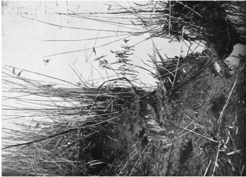
Fig. 4. Oeverbeschadiging door het woelen van bisamratten.
